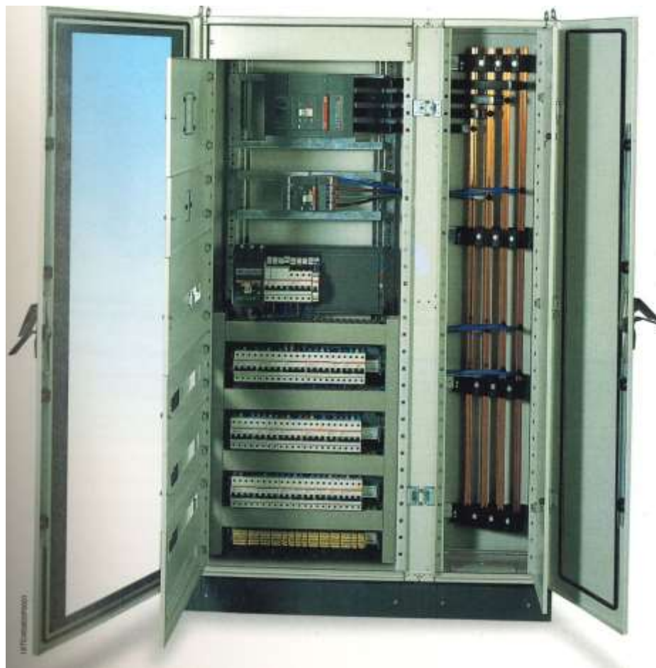
Quadro secondario di distribuzione
