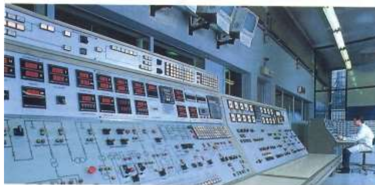
Quadri di protezione e misura
